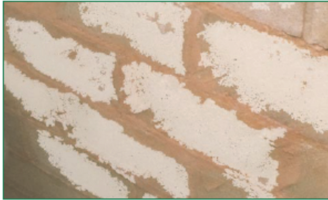
図 6.5 軽量コンクリートブロックに残ったアスベスト
